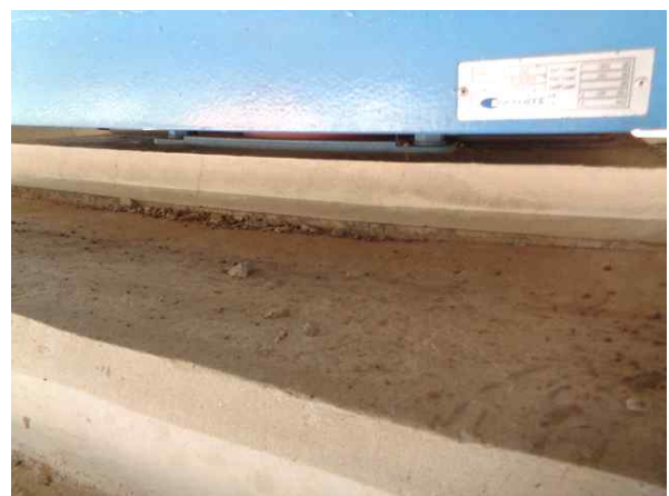
P5-Sh11 받침몰탈 균열 (0.1mm/0.2m×2EA)
