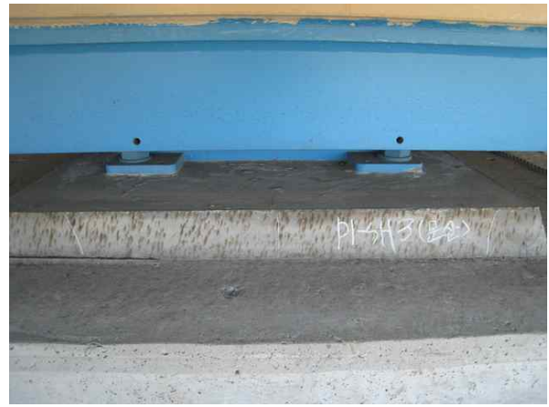
P1-Sh3 받침몰탈 균열 (0.1mm/0.1m×3EA)
