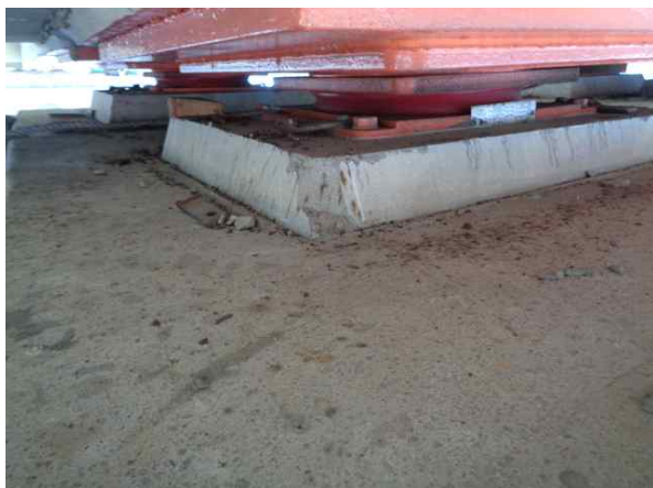
P5-Sh7 받침몰탈 파손 (0.1m×0.1m)
