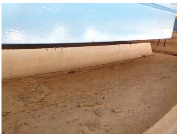
P5-Sh10 받침몰탈 균열 (0.1mm/0.2m×2EA)
