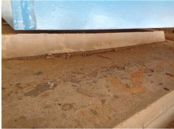
P5-Sh8 받침몰탈 균열 (0.1mm/0.2m×2EA)
