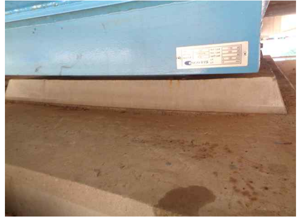
P5-Sh4 받침몰탈 균열 (0.1mm/0.2m×2EA)
