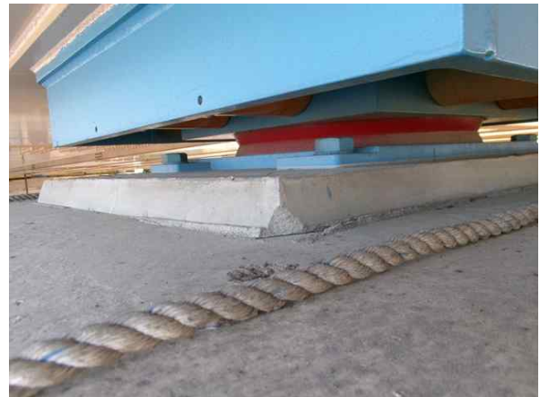
P2-Sh3 받침몰탈 파손 (0.1m×0.1m)
